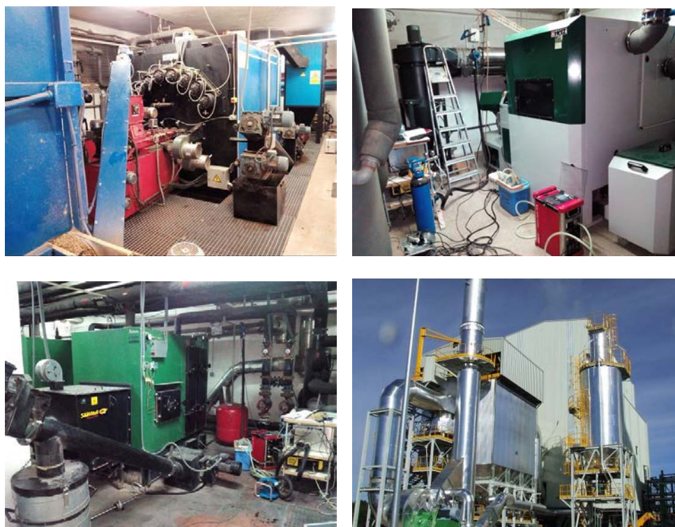
Figura1. Calderas utilizadas en los ensayos de combustión: Las Navas del Marqués (arriba, izquierda), Fabero (arriba, derecha), CEDER-CIEMAT (abajo, izquierda), GESTAMP – Garray (abajo, derecha)
