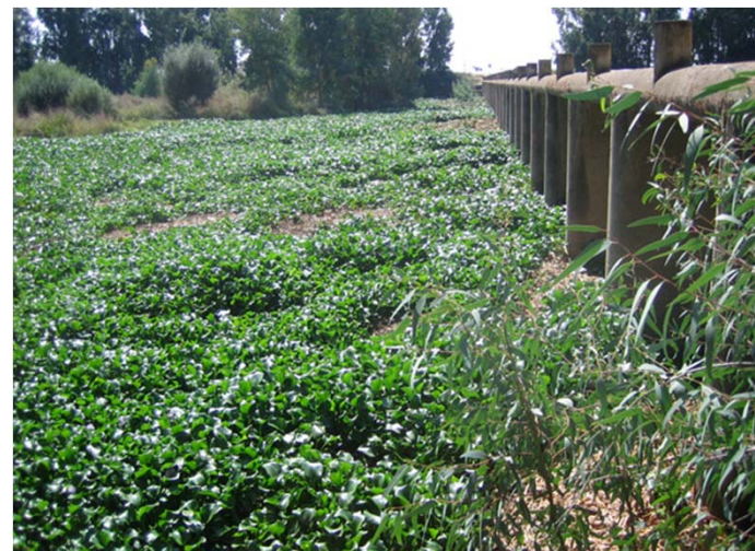
Tapona infraestructuras hidráulicas
